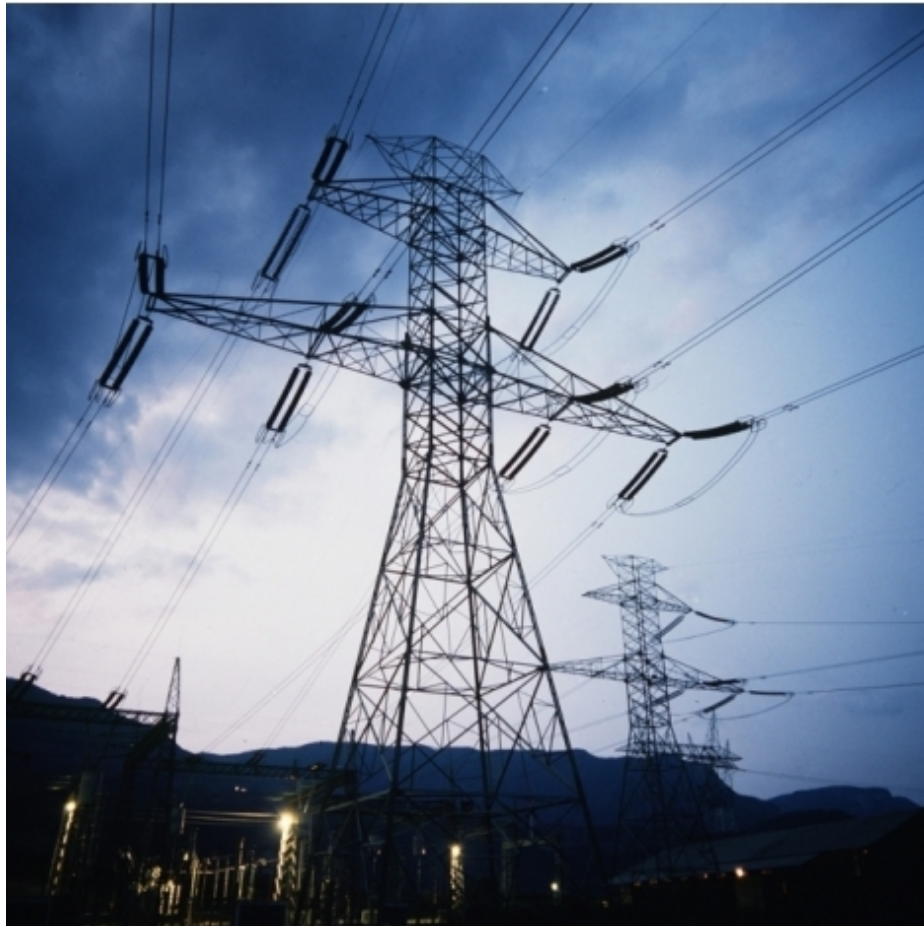
Líneas aéreas de transmisión eléctrica Manzanillo, Colima
