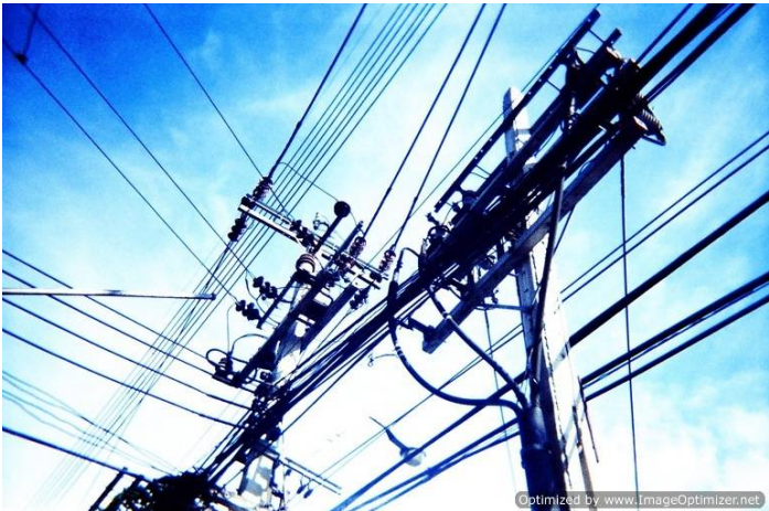
La infraestructura eléctrica es propiedad de la nación
