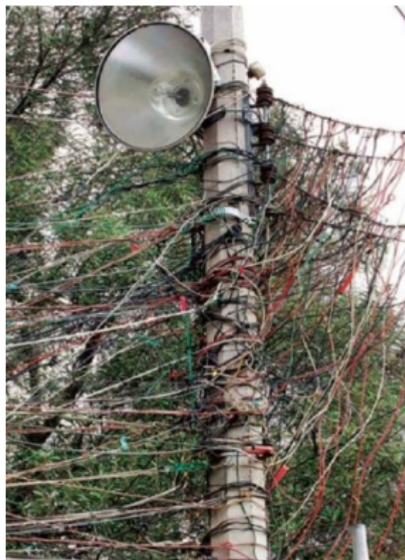
Cables eléctricos en Xochimilco. Maraña de "diablitos" e intereses corruptos afectan a la industria eléctrica nacionalizada
